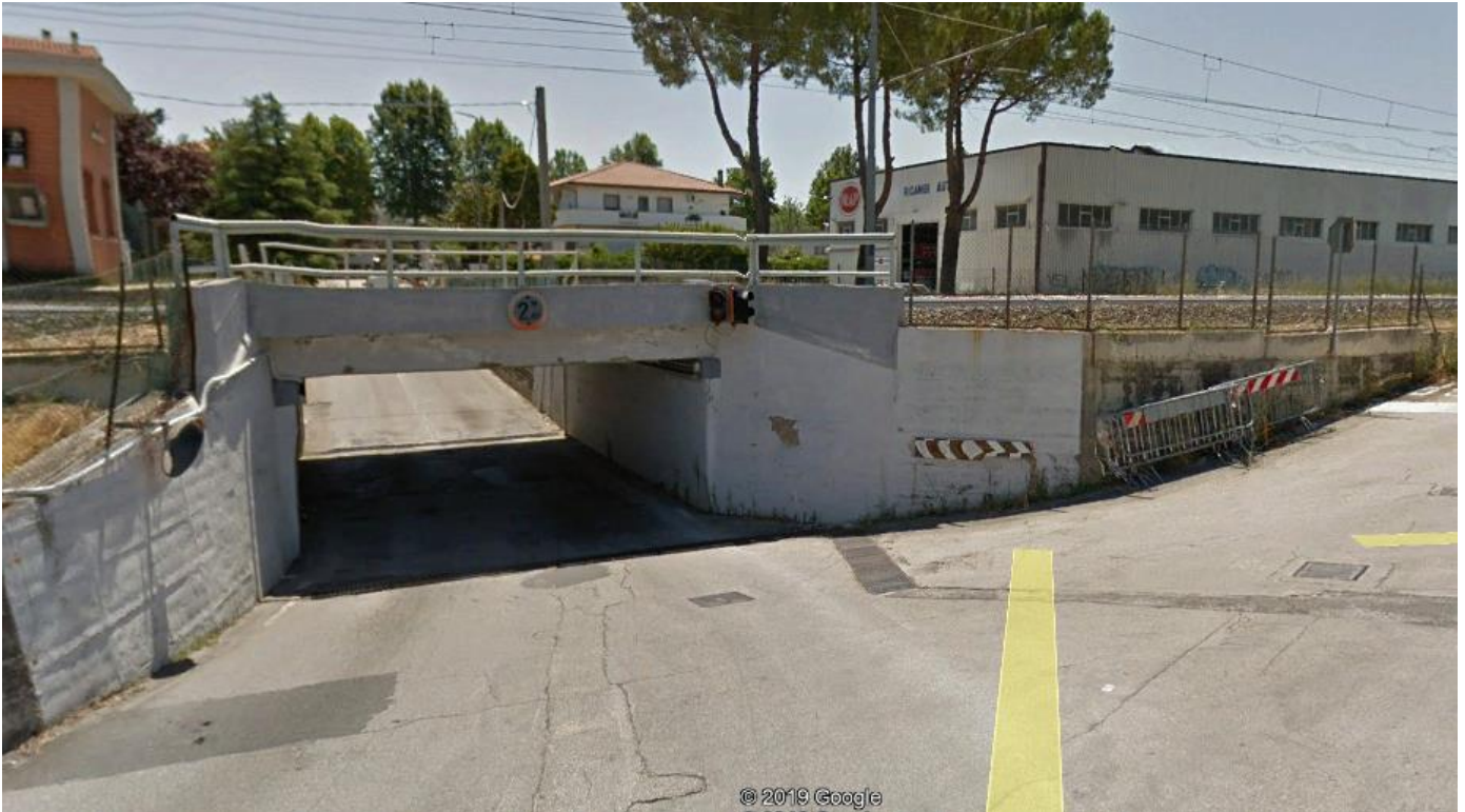
Figura 40 - Vista del sottovia esistente in direzione di Via Vittorio Emanuele. Tra le problematiche più evidenti risulta l'esiguità dell'altezza libera disponibile e le importanti pendenze che caratterizzano i rami in approccio al sottovia
